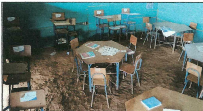
Foto 4: Vista de la condicion actual del modulo de aulas. Se observa la incomodidad debido al piso de tierra.
