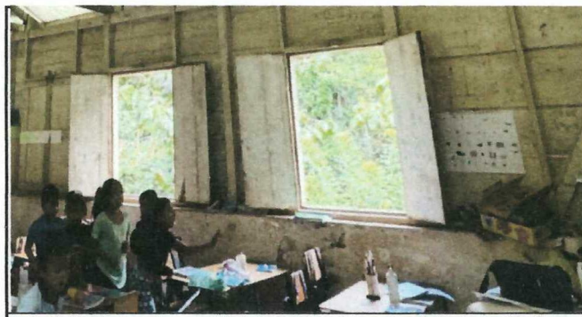
Foto 6: Se observa la necesidad de culminar los muros del aula con block para brindar comodidad y seguridad a los niños del centro educativo.
