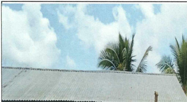
Foto 2: Vista de la cubierta de lamina detereorada. Tambien se sustituirá la estructura de techo de madera por metal.
